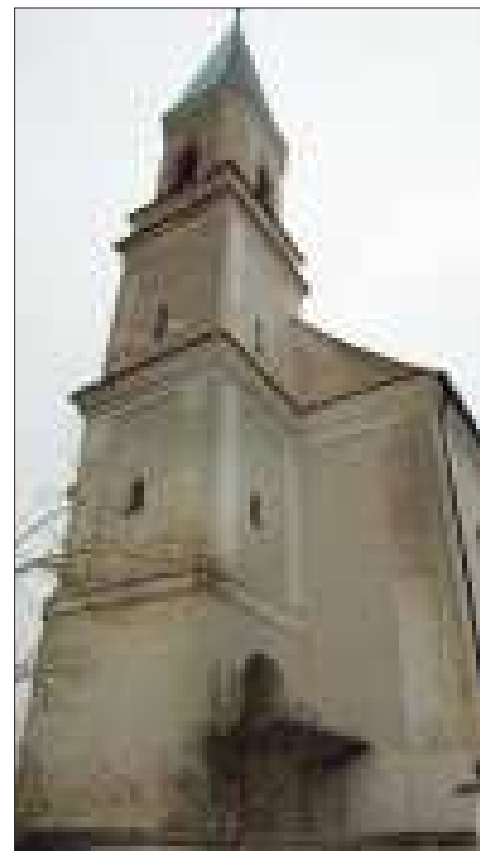
Von der Fassade der ehemaligen Wallfahrtskirche bröckelt der Putz.
